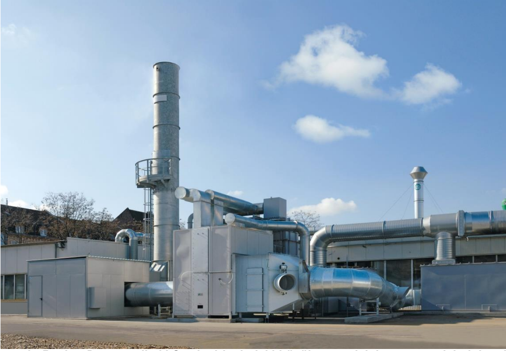
2 nolu Resim: Dortmund'teki Stork şirketindeki büyük parça lak boyama tesislerinin çıkışındaki moleküler elekli Duplex tesisi
