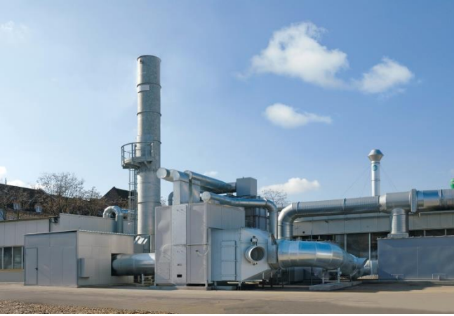
7 nolu Resim: Yakma [ünitesi] bulunan Duplex tesisi
